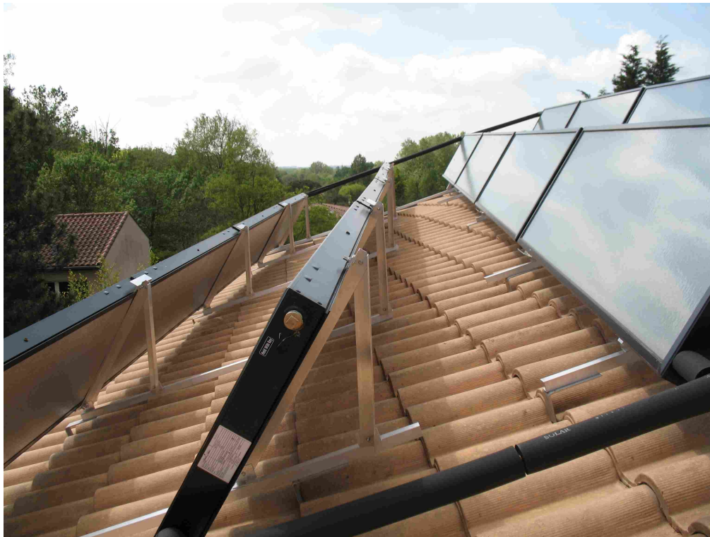
Les capteurs sur la toiture
